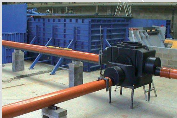
Tests hydrauliques à 10 L/s avec 100% de rendement
